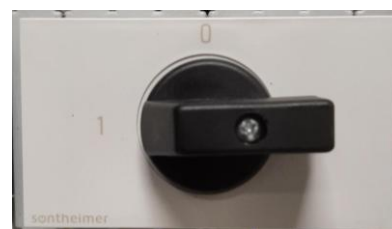
Position 1 : Les charges secourues sont alimentées par EDF. A activer en cas de défaut onduleur.
